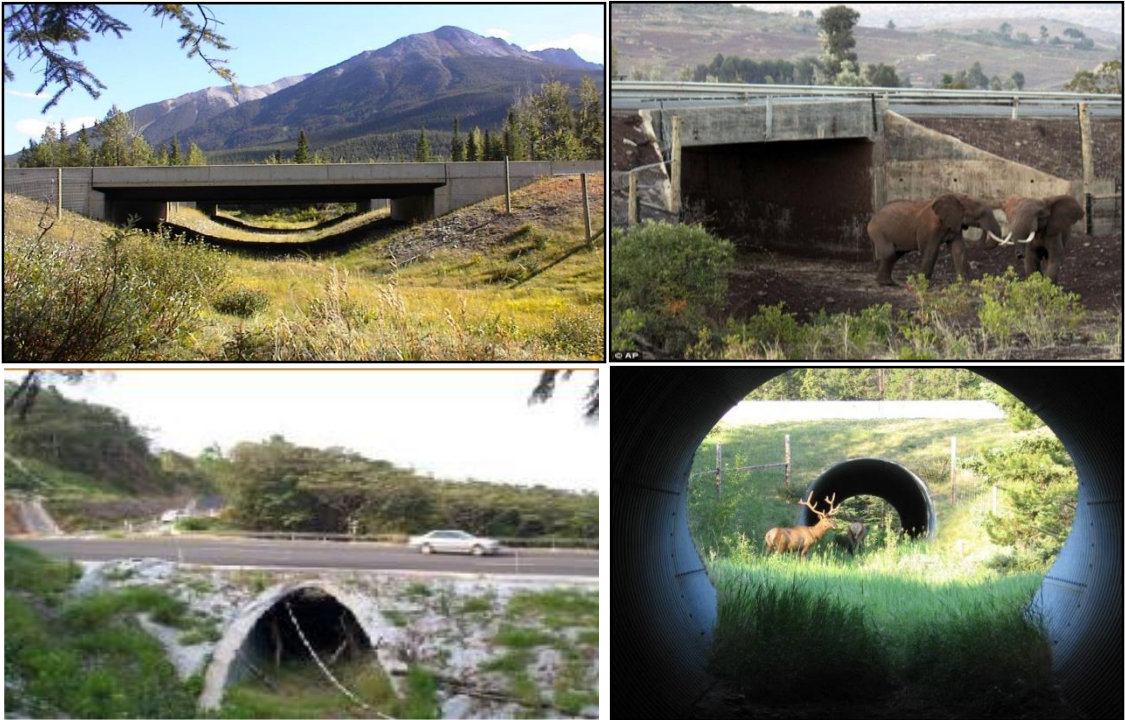
රූපසටහන 5.3: සතුන්ට ගමන් කිරීම සඳහා සැලසුම් කරන ලද යටිමං මාර්ග සහ බෝක්කු
